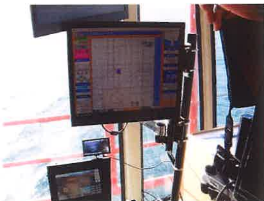
均し管理システム画面（操縦室）
